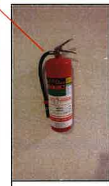
ถังดับเพลิง
