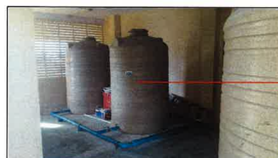
ถังเก็บน้ำใต้ดินขนาด 2.00 ลบ.ม. จำนวน 4 ถัง
