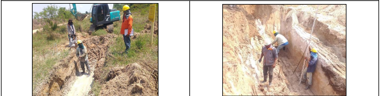
การสำรวจระบบท่อส่งก๊าซธรรมชาติและระบบสาธารณูปโภคใกล้เคียง
