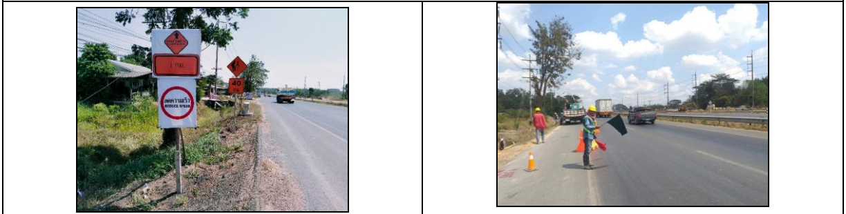
การติดตั้งป้ายเตือนจราจรก่อนถึงพื้นที่คลังน้ำมัน และผู้อำนวยการความสะดวกจราจร
