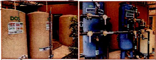
ถังเก็บน้ำใต้ดินขนาด 2.50 ลบ.ม จำนวน 3 ถัง
