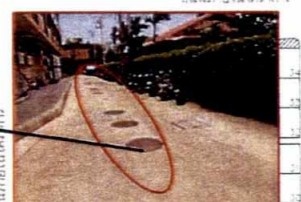
ถังบำบัดน้ำเสียชนิดเติมอากาศ อัตราการบำบัด 25 ลบ.ม./วัน จำนวน 4 ถัง (จุดบำบัดที่ 1-4) (ลักษณะเหมือนกัน)
