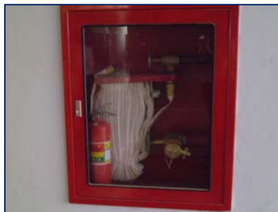
รูปที่ 2.2.3 อุปกรณ์ดับเพลิง
