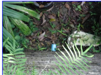
รูปที่ 2.2.8 ระบบรางระบายน้ำ
