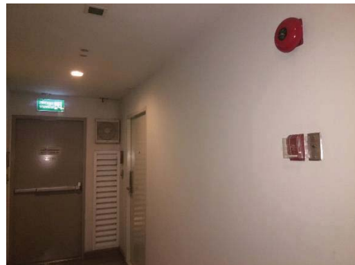
ประตูทางหนีไฟ
