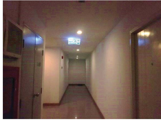
ป้ายบอกทางหนีไฟ
