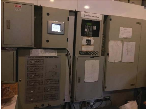
แผงควบคุม
