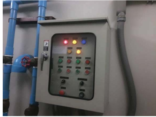
ระบบปั้มน้ำขึ้นใต้ดิน
