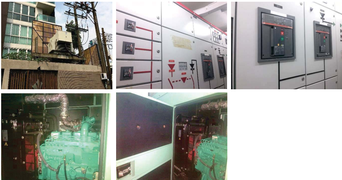
ภาพที่ 1.3.8-1 ระบบไฟฟ้าหลักและระบบไฟฟ้าสำรอง
