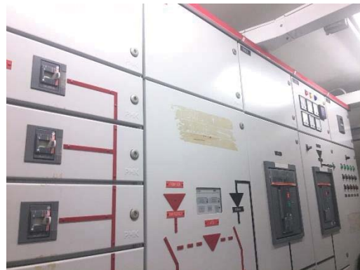
ห้องไฟฟ้า
