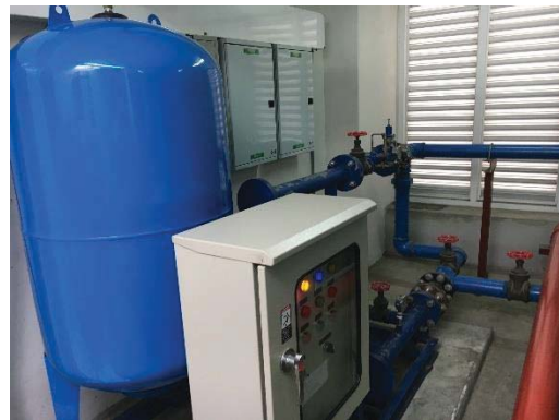
ระบบปั้มน้ำชั้นดาดฟ้า
