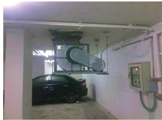
พัดลมระบายอากาศชั้นใต้ดิน
