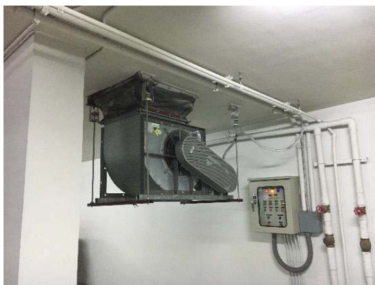
พัดลมระบายอากาศชั้นใต้ดิน
