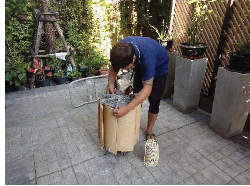
ตรวจสอบระบบกรองสระว่ายน้ำ
