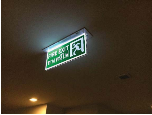
ป้ายบอกทางหนีไฟ
