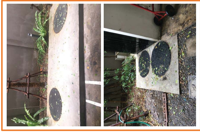
ระบบบำบัดน้ำเสียโชนทิศเหนือ
