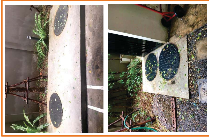
ระบบบำบัดน้ำเสียอัตโนมัติ
