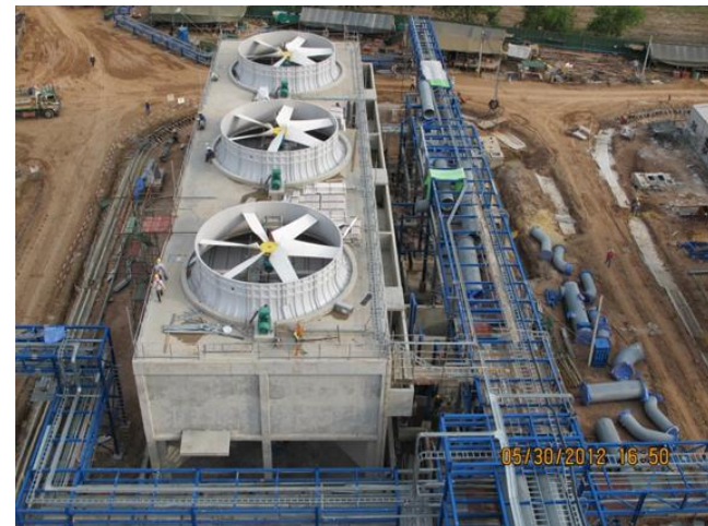
หอหล่อเย็น (Cooling Tower)
