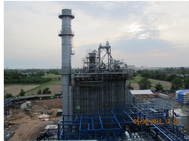
หม้อไอน้ำ (HRSG)
