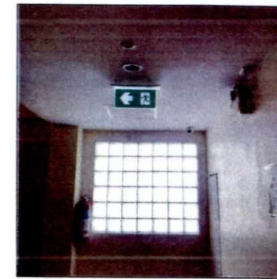
ไฟฉุกเฉิน ถังดับเพลิง และป้ายทางหนีไฟ
