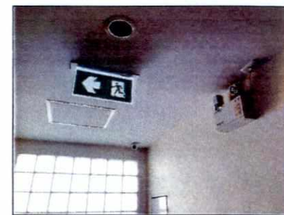
ไฟฉุกเฉิน ป้ายทางหนีไฟ และกล้องวงจรปิด
