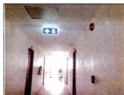
ถังดับเพลิง ปุ่มกดและกริ่งสัญญาณเตือนภัย
