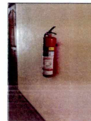
ถังดับเพลิง
