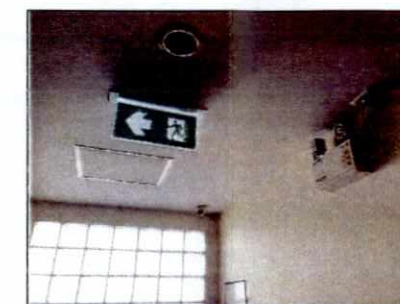
ไฟฉุกเฉิน ป้ายทางหนีไฟ และกล่องวงจรปิด
