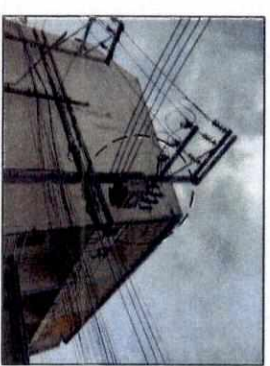
หม้อแปลงไฟฟ้า
