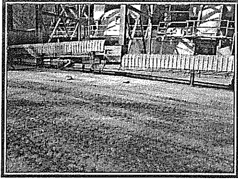
(1) สถานที่ติดตั้ง PH-C Boiler (Calciner Line) ของ Line 1
