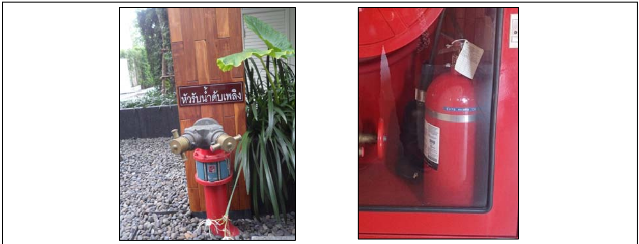
ภาพที่ 2-7 หัวรับน้ำดับเพลิง และถังดับเพลิง
