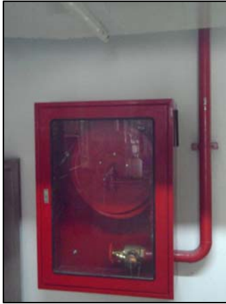
ภาพที่ 1-18 ตู้เก็บอุปกรณ์ดับเพลิง และสายส่งน้ำ
