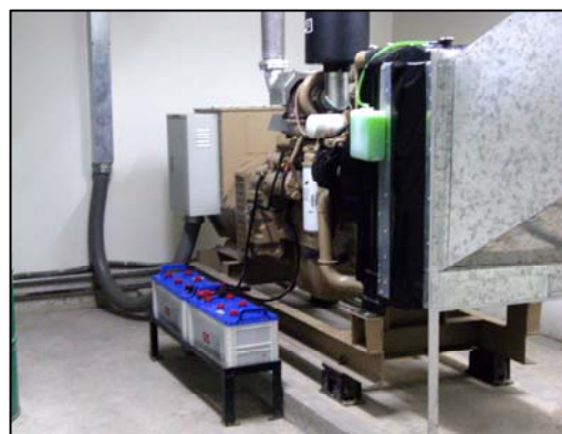
ภาพที่ 1-9 ระบบไฟฟ้าภายในอาคาร
