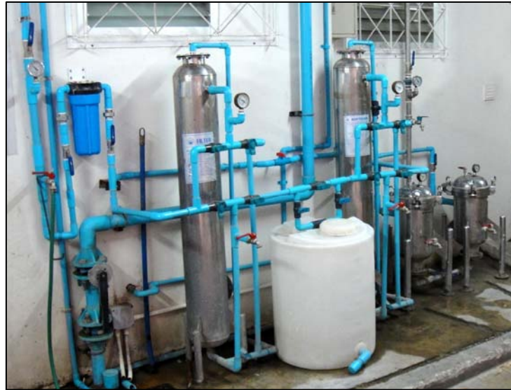
ภาพที่ 2-11 ระบบกรองน้ำเพื่อใช้บริโภค
