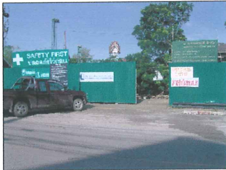
ภาพที่ 5 ป้ายรายละเอียดโครงการและป้ายเตือนอันตราย ด้านหน้าโครงการ
