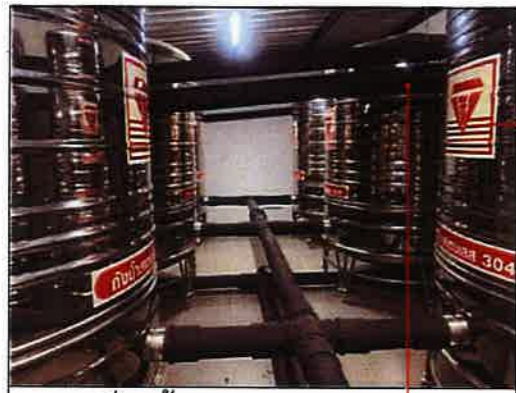
ถังเก็บน้ำดี ขนาด 2,500 ลิตร จำนวน 8 ถัง
