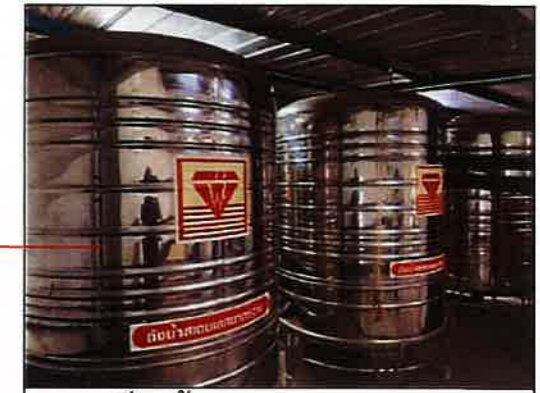
ถังเก็บน้ำดี ขนาด 2,500 ลิตร จำนวน 8 ถัง
