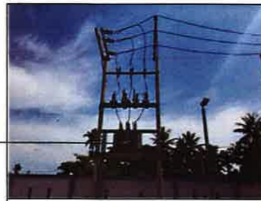
หม้อแปลงไฟฟ้าขนาด 500kVA
