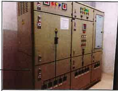
แผงควบคุมไฟฟ้ารวม (MDB)
