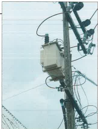
หม้อแปลงไฟฟ้า ขนาด 250 kVA
