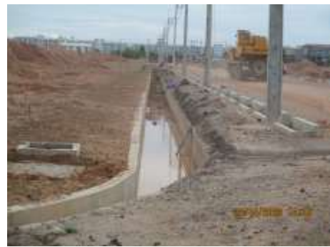
รูปที่ 12 รางระบายน้ำถาวร
