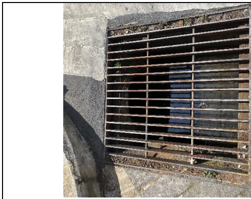
ภาพที่ 12 รางระบายน้ำฝน
