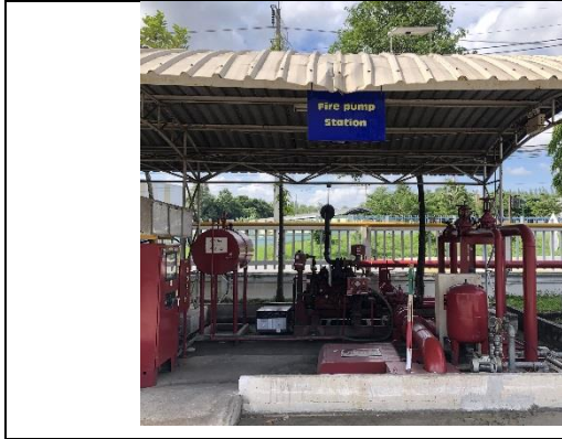
ภาพที่ 16 เครื่องสูบน้ำดับเพลิงและหัวรับน้ำดับเพลิง
