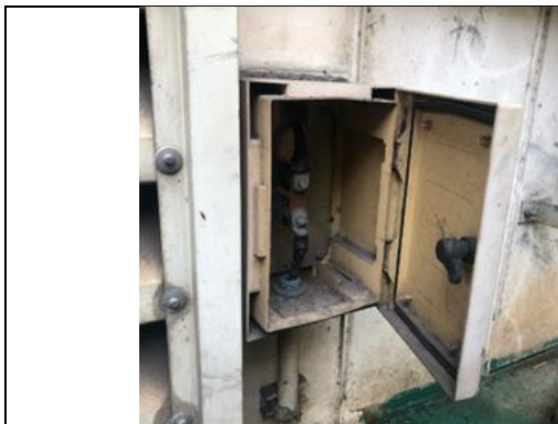
ภาพที่ 22 สายล่อฟ้าภายในพื้นที่โครงการ
