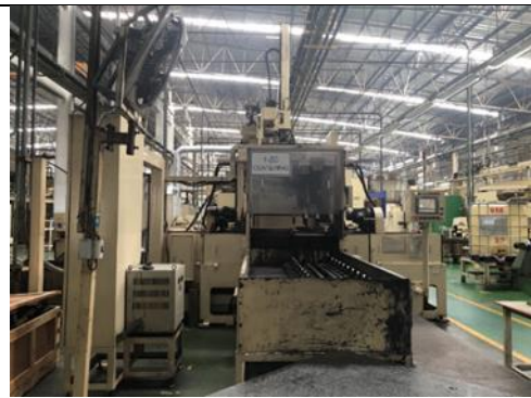
ภาพที่ 21 อุปกรณ์ไฟฟ้ามีสายดินทุกระบบ
