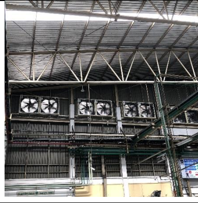
ภาพที่ 17 ระบบระบายอากาศในพื้นที่ทำงาน
