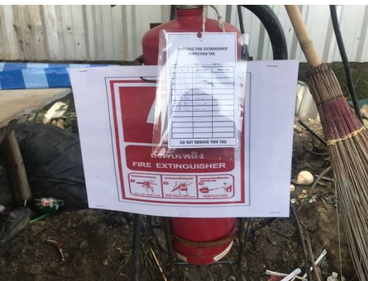
ภาพที่ 11 ถังเก็บดับเพลิง
