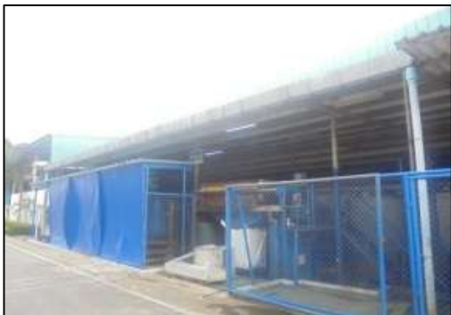
ภาพที่ 5 ระบบบำบัดน้ำเสีย
