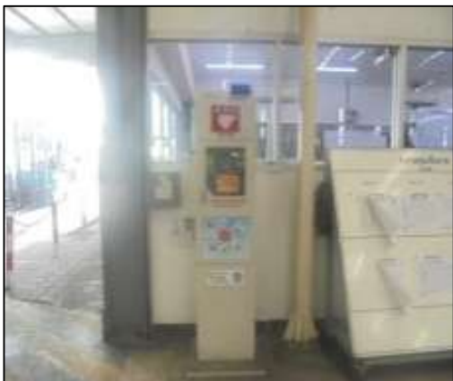
ภาพที่ 15 อุปกรณ์ฉุกเฉินในอาคารส่วนการผลิต
