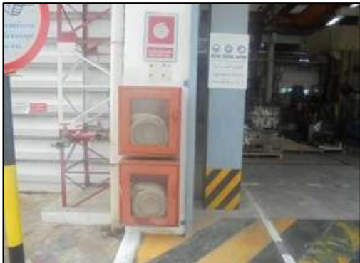
ภาพที่ 19 อุปกรณ์ป้องกันอัคคีภัยในอาคาร
