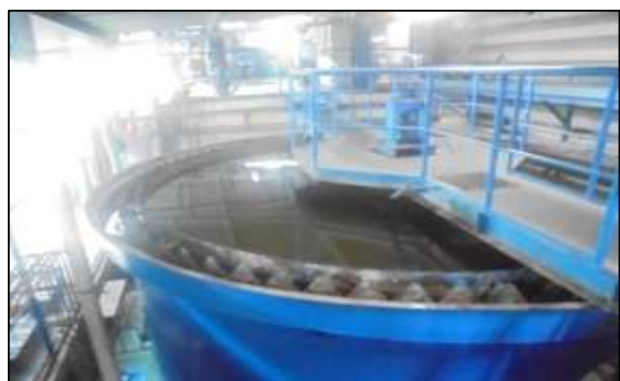
ภาพที่ 8 ระบบบำบัดน้ำเสียทางเคมีทางชีวภาพ
