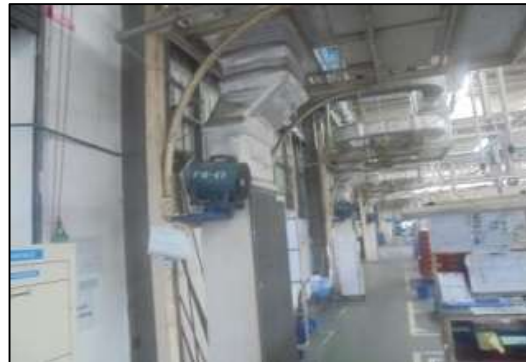
ภาพที่ 20 ระบบระบายอากาศในอาคารผลิต
