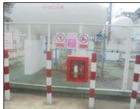
ภาพที่ 32 ภาพถ่ายอุปกรณ์ป้องกันอัคคีภัย
