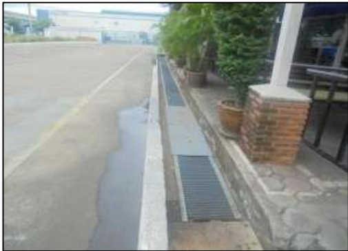
ภาพที่ 11 รางระบายน้ำฝน
