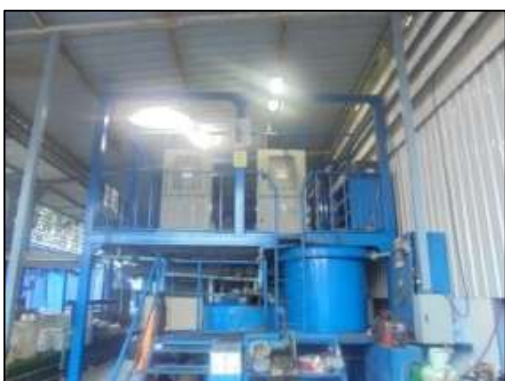
ภาพที่ 7 ระบบบำบัดน้ำเสียทางเคมี
