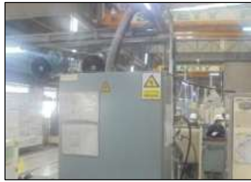
ภาพที่ 18 ป้ายเตือนอันตรายจากไฟฟ้า
