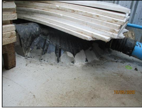
รูปที่ 1-3 ระบบบำบัดน้ำเสียสำเร็จรูปชั่วคราว
