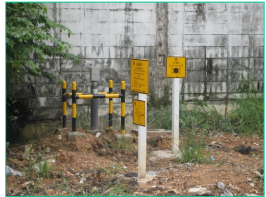
ป้ายเตือนบอกตำแหน่ง CP Test Post
