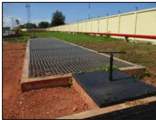
บ่อแยกไขมัน
