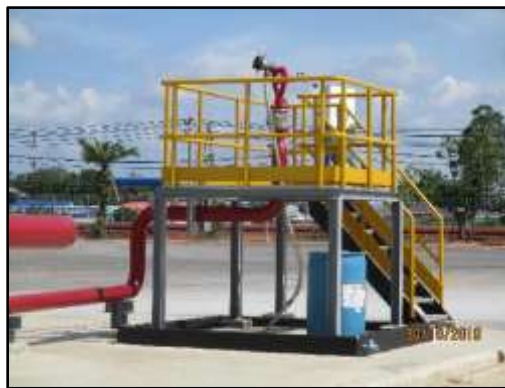
รูปที่ 2-24 ระบบฉีดน้ำดับเพลิงแบบโฟม
