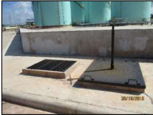
ร่างระบายนํ้าปนเปื้อนน้ำมัน
