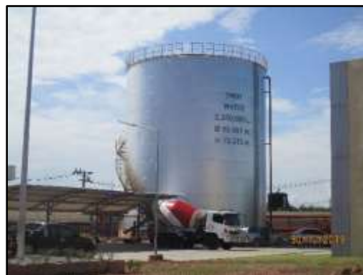
รูปที่ 2-16 ถังสำรองน้ำภายในพื้นที่โครงการ
