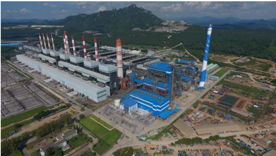
รูปที่ ๓-6 ภาพมุมสูงความก้าวหน้าการก่อสร้างโครงการพัฒนาโรงไฟฟ้าทดแทนเครื่องที่ 4-7 ตุลาคม 2561
