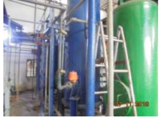
รูปที่ 12 ระบบปรับสภาพน้ำ
