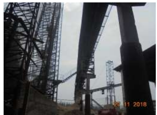
รูปที่ 5 ระบบสายพานลำเลียง
