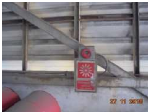
สัญญาณเสียงแจ้งเตือนเหตุไฟไหม้ (Alarm bell)
